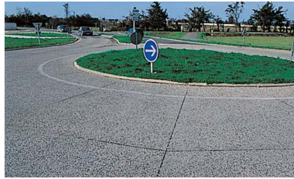
Calepinage soigné de la chaussée annulaire : dalles à forme tronconique ne comportant pas d'angles aigus.
