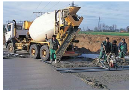
Le béton prêt à l'emploi est particulièrement adapté (en quantité et en qualité) à la réalisation des carrefours giratoires .
