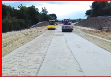
Atelier de compactage de la couche de forme traitée au chanvre et au liant hydraulique routier.
