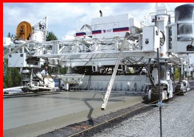
Chaussée composite. Mise en œuvre du béton, à l'aide d'une machine à coffrages glissants, sur une fondation en grave-bitume.
