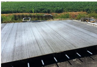
Les goujons métalliques d'une longueur de 0,45 m et d'un diamètre de 30 mm.
