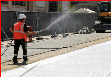
Un géotextile est déployé pour protéger la nouvelle chaussée. But : renforcer encore la prise du béton. Il sera arrosé toutes les heures jusqu'au soir.
