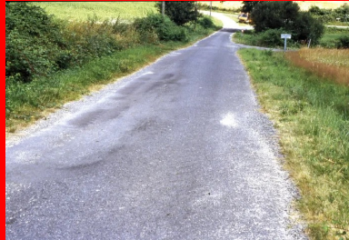
Vue générale d'une route dégradée structurellement
