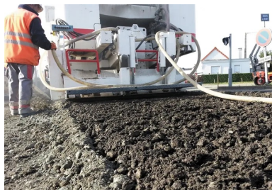
L'ARC® 1000 vu de l'arrière, avec le mélange homogène résultant du broyage de l'ancienne chaussée préalablement scarifiée.
