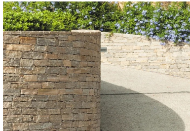
Pour stabiliser les aires, un mur de soutènement a été construit sur les trois quarts du tracé. Des traversées de route, avec grille en fonte, ont été aménagées tous les 10 m.
