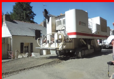
Vue de l'arrière de l'ARC 1000 d'Eiffage. Cette véritable « centrale mobile » décohésionne l'ancienne chaussée « transversalement et verticalement », mélange le liant avec le matériau en place avant l'homogénéisation de l'ensemble des constituants à l'aide d'un malaxeur intégré.
