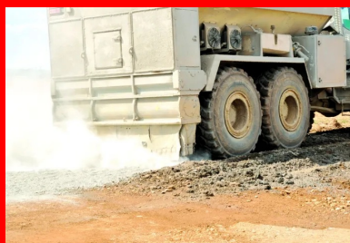
Epandage du liant hydraulique routier Rolac® Premier 635 de LafargeHolcim sur le fraisat de l'ancienne chaussée préalablement défragmentée.
