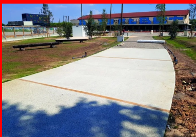
En juin 2018, les premières planches d'essais sont coulées à l'entrée du parc de la Station Mue. « Nous avons commencé par faire de petites planches, puis, de fil en aiguille, des planches de plus en plus grandes, poursuit Nicolas Brasier (Vicat). Finalement, nous avons atteint les objectifs : créer un nouveau béton à partir de rebuts de béton. »
