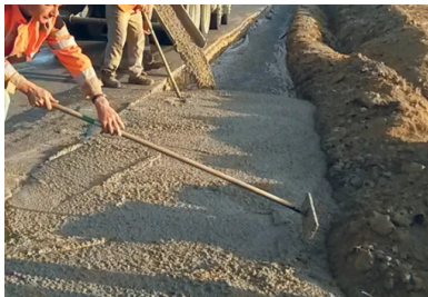
Les premières poutres Maces (40 cm d'épaisseur) ont été réalisées à compter de début septembre 2018. La mise en œuvre s'est effectuée par simple versement dans la fouille depuis les toupies, suivi d'un traitement manuel léger et d'une finition au râteau.
