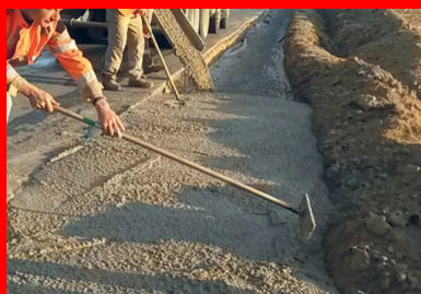
Les premières poutres Macés (40 cm d'épaisseur) ont été réalisées à compter de début septembre 2018. La mise en œuvre s'est effectuée par simple versement dans la fouille depuis les toupies, suivi d'un traitement manuel léger et d'une finition au râteau.
