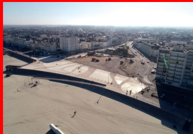
Une première phase de requalification concerne 17 000 m 2 . Quelque 3 200 m 3 de béton ont été mis en œuvre par Eurovia, soit 400 toupies de 8 m 3 .
