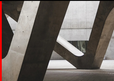
Réparation et renforcement des structures en béton au moyen de matériaux composites
