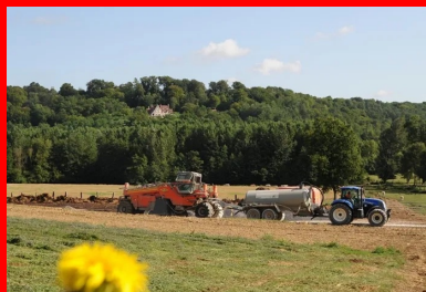
Technique éprouvée, le retraitement en place au LHR combine intégration écologique et respect du site, en évitant notamment l'extraction et la mise en décharge des matériaux pollués par une noria de camions
