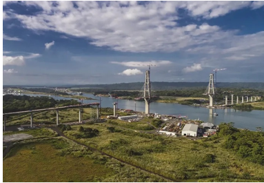
Les voussoirs du pont à haubans sont construits de manière symétrique par rapport à chacun des pylônes, afin d'éviter le déséquilibre des charges.
