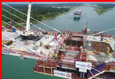
Le bétonnage de la zone de clivage permet de solidariser les deux fileaux du pont à haubans.
