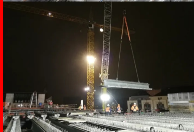
Le tablier est constitué de poutres préfabriquées en béton en forme de T inversé.
