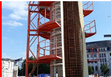
Les piles en béton blanc autoplaçant coulé en place portent la mezzanine.
