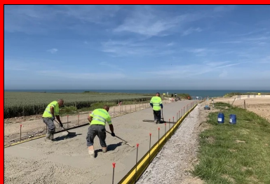
L'étalage du béton s'effectue à l'aide de différents outils : râteau, épancheur ou lissarde.
