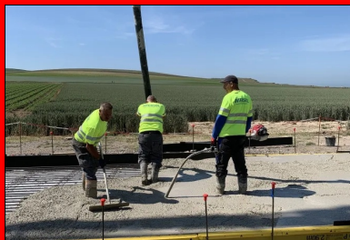
Bétonnage : alimentation du béton à la pompe, réglage au râteau, suivi du serrage du béton à l'aiguille vibrante.
