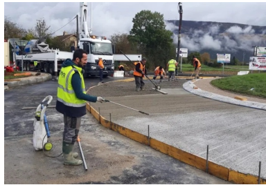
La protection du béton a été assurée par un produit de cure qui a été pulvérisé immédiatement après le traitement de surface.
