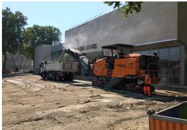
Travaux de démolition de l'ancien parvis et mise à nu du support.
