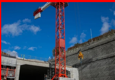
Pour résister à un éventuel recroûte dans le tunnel, le béton armé de la tranchée couverte ne dispose pas de protection au feu rapportée, mais d'une formulation spécifique : celle-ci intègre des fibres synthétiques en polypropylène qui, en fondant sous l'effet de la chaleur, libèrent des canaux connectés à l'intérieur du béton laissant la vapeur d'eau s'échapper, ce qui permet de maîtriser les risques de fissuration et d'écaillage du béton.
