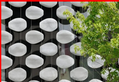
À l'étage, un moucharabieh contemporain, composé de pièces en béton fibré à ultra hautes performances (BFUP), protège l'intimité des espaces privés et réduit l'impact solaire sur les grands vitrages.
