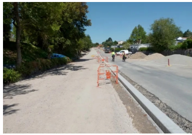
Après les travaux préparatoires de la piste cyclable, la bordure en béton - séparant la piste cyclable/noue de la chaussée - a été coulée en place à l'aide d'une machine à coffrages glissants.
