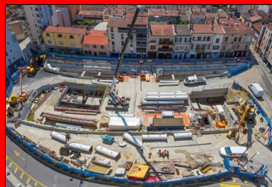
© ACTOPHOTO Station Oullins Centre : l'emprise du chantier est à peine plus grande que la dalle de couverture de la gare.
