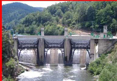
Avec ses trois vannes et ses passerelles, l'ancien barrage mesurait près de 20 m de hauteur.
