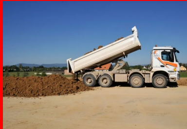
Acheminement des matériaux depuis le dépôt provisoire et mise en place sur site pour une épaisseur finale de 35 cm.
