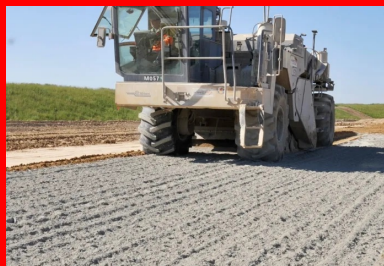
Un liant spécifique (ROC COS) a été développé par EQIOM en lien avec les équipes du projet, puis livré entre 2019 et 2021 en fonction des phasages du projet.
