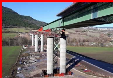
Lançage de la charpente. D'abord assemblé sur une plateforme installée sur l'une des deux culées de l'ouvrage, le tablier a été mis en place au cours de huit lançages successifs, muni d'une partie du ferrillage du hourdis supérieur ainsi que des prédalles et du ferrillage du hourdis inférieur. ©CEREMA
