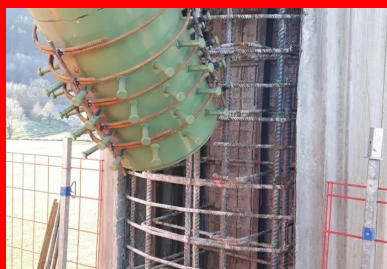
Clavage des entretoises des piles avec les fûts. Des réservations sont réalisées dans les fûts au droit de la jonction avec les extrémités des croix métalliques. Un ferrillage (non visible sur la photo) reliant les deux éléments est mis en place avant de couler le béton qui formera les bossages (visibles sur la photo n° 6). ©CEREMA
