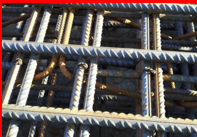
Ferrailage du hourdis inférieur. La densité d'armatures de cette dalle est très importante (environ 300 kg/m 3 , contre 250 kg/m 3 pour le hourdis supérieur). ©DIR Med
