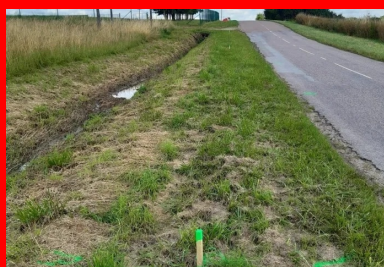
État de la chaussée avant les travaux.
