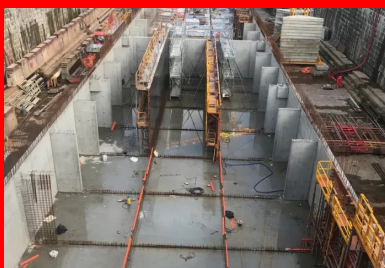
Vue du niveau inférieur du ponton en construction. Les voiles périphériques et le cloisonnement intérieur permettent de créer 12 alvéoles indépendantes garantissant le maintien en flottaison de l'ouvrage en cas d'avarie.
