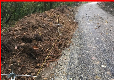
Couche de forme avec enduit de protection prête à recevoir le revêtement en béton. Fils de guidage de la machine à coffrages glissants déjà en place.
