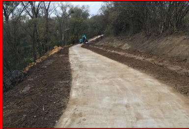
Travaux de mise à niveau des accotements associés aux travaux de stabilisation des berges.
