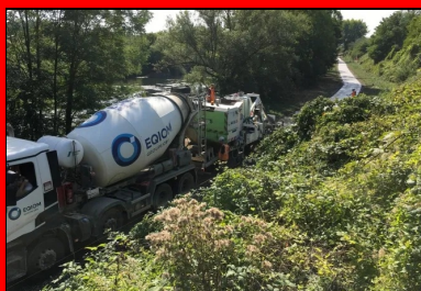
Le béton fabriqué à la centrale d'Illange d'EQIOM est livré par camions-toupies devant la machine à coffrages glissants.
