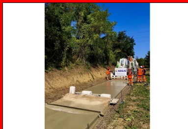
La machine à coffrages glissants, tractant la toile de jute, assure simultanément la réalisation du revêtement en béton et le traitement de surface.
