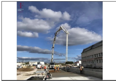
Bétonnage à la pompe et serrage du béton à l'aide d'un rouleau Striker.
