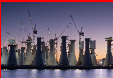
Les 71 fondations gravitaires ont été érigées en parallèle sur un quai du grand port maritime du Havre.
