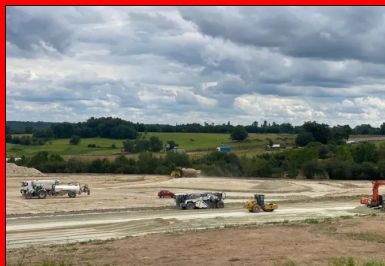
Vue de l'atelier de traitement du sol en place au liant LIGEX avec, au premier plan, un compacteur à bille lisse en action. (© D. Daguzan_Ecostab)
