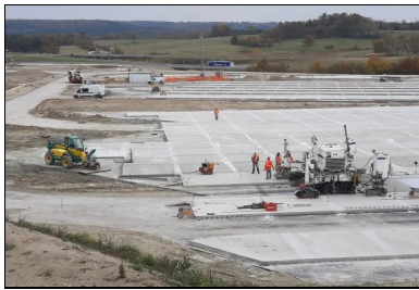
Quand elle progresse en clavage, la machine prend comme référence la hauteur des bandes existantes situées de part et d'autre. Le guidage en direction est donné par un fil. (© Luc Lefoll, Eurovia)
