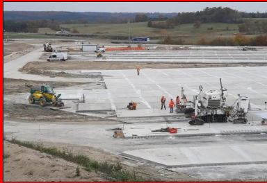
Quand elle progresse en clivage, la machine prend comme référence la hauteur des bandes existantes situées de part et d'autre. Le guidage en direction est donné par un fil. (© Luc Lefol, Eurovia)
