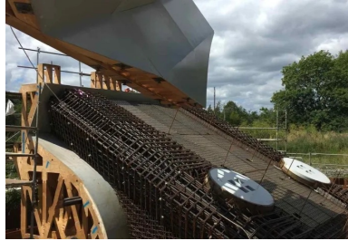
Des efforts colossaux transitent dans les massifs de pieds d'arcs, par l'intermédiaire des pièces d'ancrage des pilettes (les « disques » sur la photo), et des inserts métalliques en tête. C'est pour cette raison que les massifs intègrent une très forte densité d'armatures - jusqu'à 300 kg/m 3 de béton. © photothèque NGE
