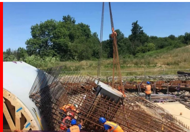
Amorce de pied d'arc en cours de réalisation. La précision de positionnement des différentes parties de l'ouvrage constituait l'un des défis techniques du chantier pour NGE GC. Ainsi, les inserts métalliques noyés du pied d'arc (platières d'appareils d'appuis et pièces d'ancrage) sont positionnés avec une précision de \pm 0,3 millimètres. © photothèque NGE
