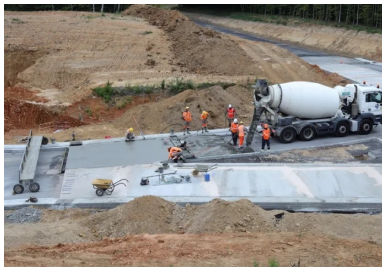
Contrôle de la consistance du béton à l'aide de l'essai d'affaissement au cône d'Abrams. (© Quentin Hognon, Colas)
