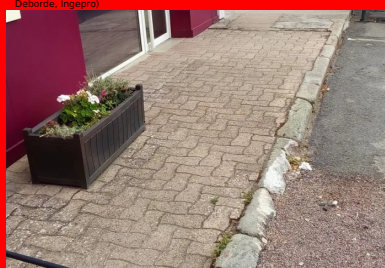
La place du Champ-de-Foire avant les travaux de rénovation. (C)Jean-Sébastien Deborde, Ingepro
