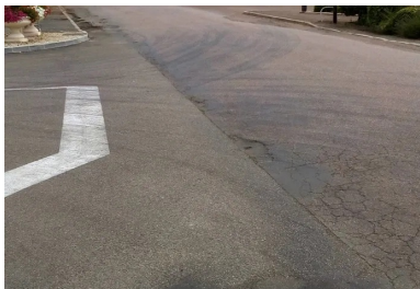
La place du Champ-de-Foire avant les travaux de rénovation. (C)Jean-Sébastien Debordé, Ingepro
