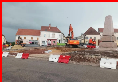
Travaux de démolition et de réalisation de la plate-forme support. (©Jean-Sébastien Deborde, Ingepro)
