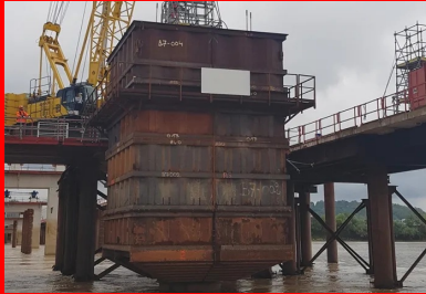
Chaque fût de pile est bétonné à l'intérieur d'un caisson étanche solidarisé au pieu de fondation, ce qui permet de limiter les affouillements.
