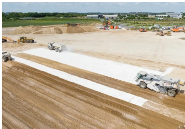
Atelier de traitement. Au fond un épandeur du liant en action et au premier plan deux pulvimixeurs mélangent le liant avec le sol sur une épaisseur bien définie. (© Colas)
