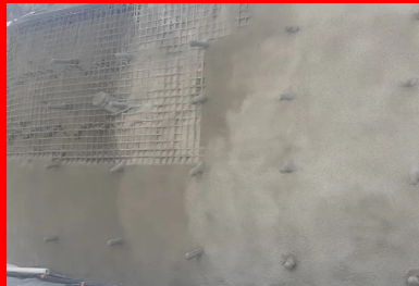
Paroi clouée, brèche n° 40.
