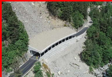
Paravalanche RD 91. La galerie paravalanche combine des éléments préfabriqués et du béton coulé en place.
