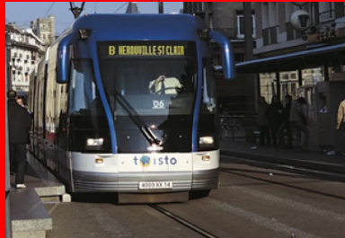
Photo 4 : arrêt et voie de tram omiérés, en cours d'usure avancée- (c) CIMbéton
