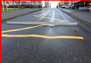
Photo 3 : arrêt de bus déformé - (c) CIMBETON
