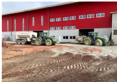
Atelier de traitement. Epandeur tracté Streamaster (à gauche) et Malaxeur tracté Wirtgen W5 250 (à droite). (© Scierie-Gaiffe et Avinim Construction)
