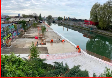
Le béton est réglé manuellement à l'aide d'une règle en aluminium, tout en respectant les repères altimétriques constitués, d'un côté, par les bordures de rive et, de l'autre côté, par des marques portées sur des piquets « repères ». (© Sébastien Vinatier/Sols)
