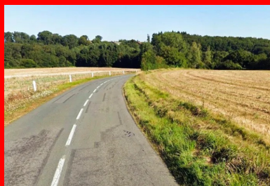
Etat de la chaussée de la RD7 sur la commune de Brux, avant les travaux de réhabilitation. (© Ludovic Padeloup/Conseil départemental de la Vienne)
