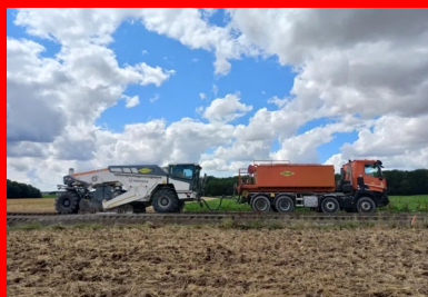
RD 119. Retraitement en place au liant hydraulique routier ROC VDS entre Briot et Briot-la-Grange. L'humidification du matériau est réalisée directement dans la cloche du malaxeur. (© Colas)
