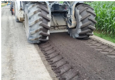
Section 2. Atelier de retraitement partiel à l'émulsion de bitume du matériau déjà retraité au liant ROC VDS. (©Colas)
