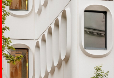
Réalisée in situ, la rénovation des façades béton valorise pleinement le dessin original de Marcel Roux.
