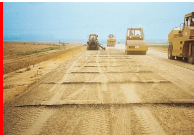
Atelier de compactage du BCR, constitué de rouleaux vibrants suivis d'un compacteur à pneus. (©Cimbéton)
