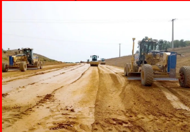
Réglage à la niveleuse pour obtenir un profil en long très régulier et atelier de compactage de la couche de forme traitée pour atteindre la compacité exigée.
