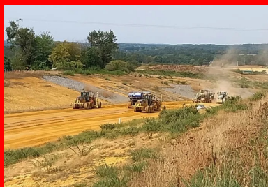
Vue générale du chantier de terrassement, conçu en circuit fermé déblais-remblais. (© Guintoli - NGE)
