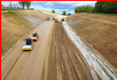
Vue générale du chantier de mise en œuvre de la couche de forme traitée au liant Rolac Premier ECOPlanet. (© Guintoli/groupe NGE)
