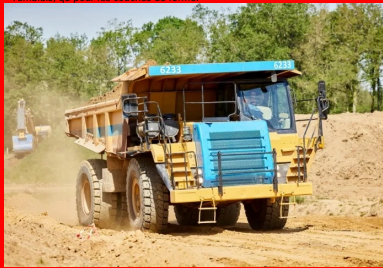
Les matériaux repris sur le stock sont acheminés à l'aide de tombereaux articulés pour être utilisés dans la confection des remblais et de la couche de forme. © Guintoli - NGE
