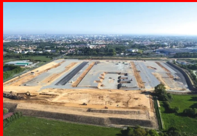
Deux vues aériennes du chantier, l'une en avril 2017 (où le traitement de plate-forme s'achève), l'autre deux mois plus tard, en juin 2017 (où la construction des premiers bâtiments commence).
