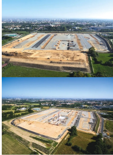
Deux vues aériennes du chantier, l'une en avril 2017 (où le traitement de plate-forme s'achève), l'autre deux mois plus tard, en juin 2017 (où la construction des premiers bâtiments commence).
