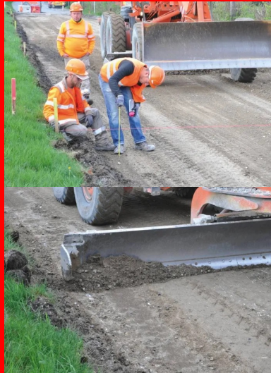
Prise de mesure de la hauteur de la chaussée retraitée avant réglage.
