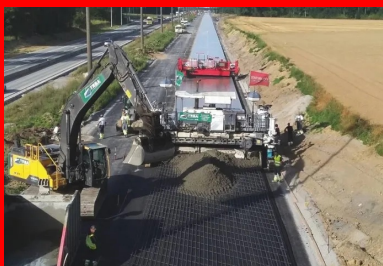
La nouvelle autoroute E42/A8 Kain-Lamain a nécessité la pose de 230 000 m 2 de BAC.
